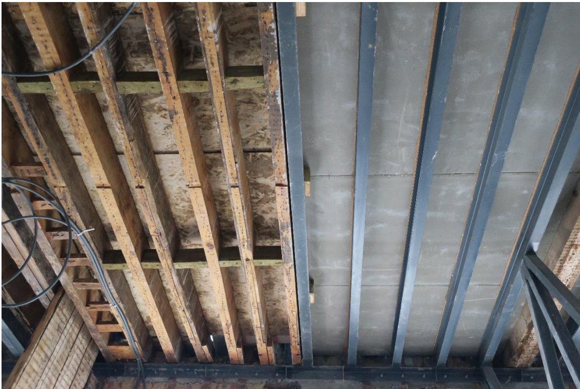
Fotografia 6 - Vista da combinação no pavimento de elementos novos metálicos com os de madeira já existentes
