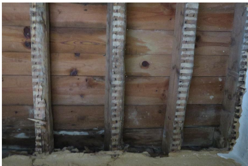
Fotografia 2 - Estado do pavimento de madeira junto às fachadas
