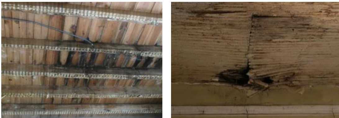
Figura 6.2 - Fotografias do estado de degradação dos pavimentos de madeira nos pisos elevados
